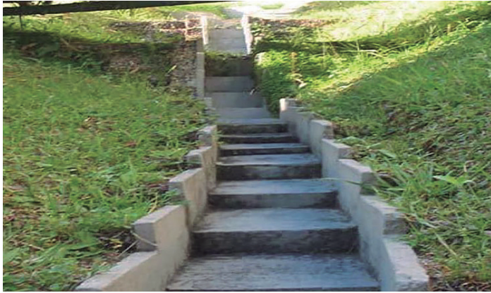
Figura 8. Disipador de energía tipo, en concreto reforzado
